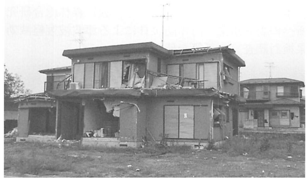
写真3：被害家屋(壁(2F)破損)の例(2011.9.30撮影)
